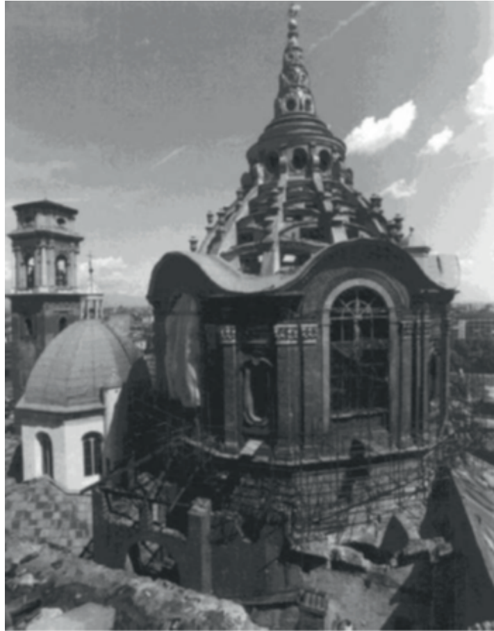
VISTA DEL TAMBURO ESTERNO AL LIVELLO III, ALL'INDOMANI DELL'INCENDIO
