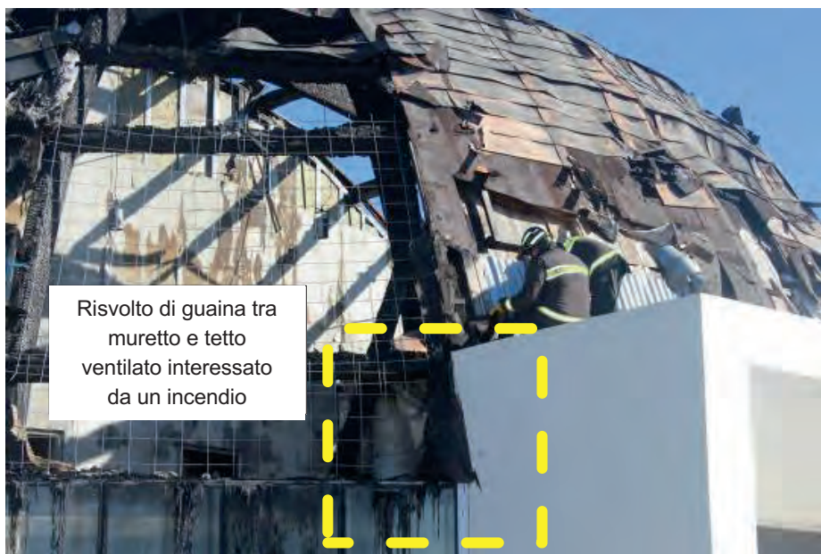
INCENDIO SU DI UNA COPERTURA DEL TIPO VENTILATO
